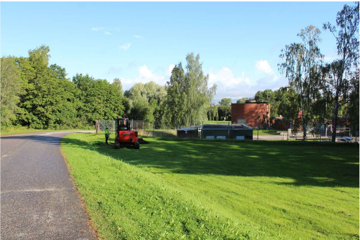
akdg6459:1. Työkuvaa. Kaivu alkaa alueen luoteisnurkasta, oja 1. Etelästä. Vasemmalla Tervanokantien luiskaa ja taustalla vedenpuhdistamo ja matonpesupaikka.
